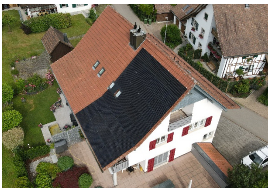
Neue PV-Anlage in der Kernzone in Schleinikon, Baujahr 2022
