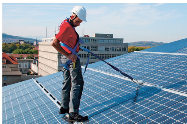
Bild 12 Anschlageinrichtung, in Solaranlage integriert
