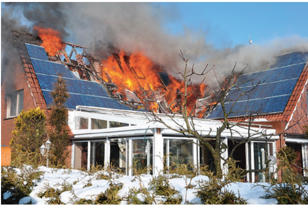
Bild 20 Brandfall bei Haus mit Solaranlage
